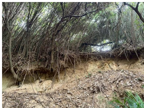
図 4.1-4 根が露出した斜面 (10/10 小野にて撮影)
