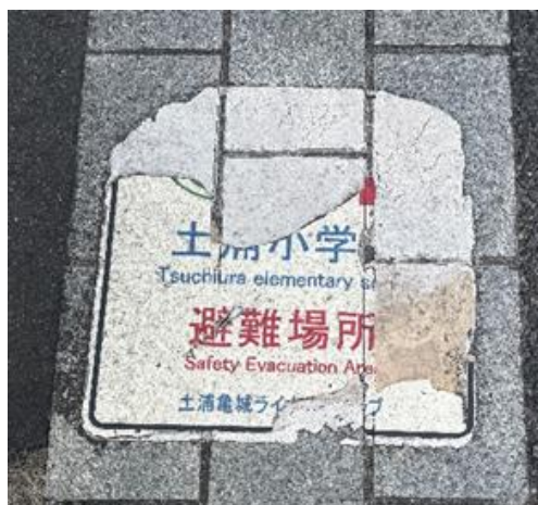
図 1.5-22 歩道上に設置された避難誘導看板
