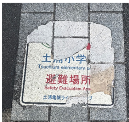
図 126 歩道上に設置された避難誘導看板
