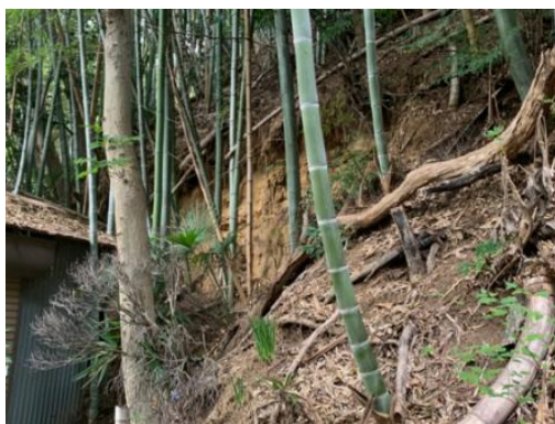
図 1-157 崩れかかっている急傾斜地（2024 年 10 月 25 日発表者撮影：西真鍋にて）
