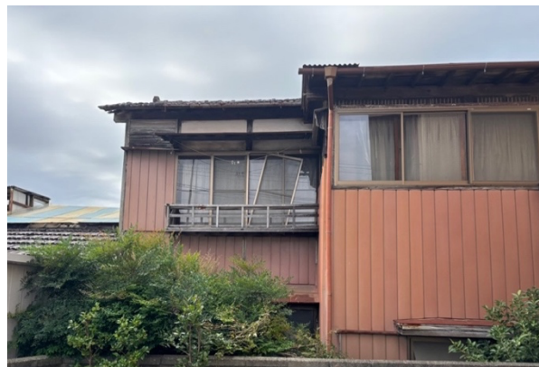
図1.3-7 神立駅周辺の空き家
