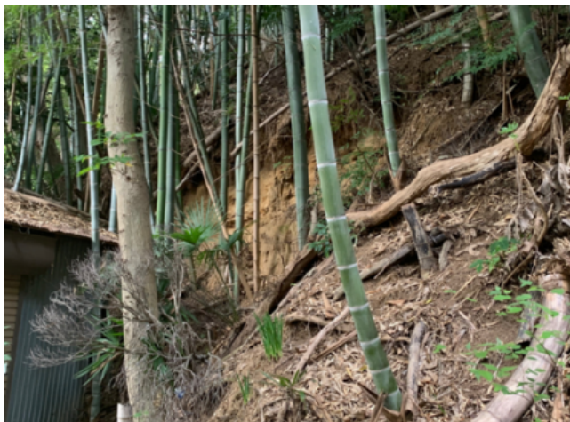
図 1.5-31 崩れかかっている急傾斜地 (2024 年 10 月 25 日発表者撮影：西真鍋にて)
