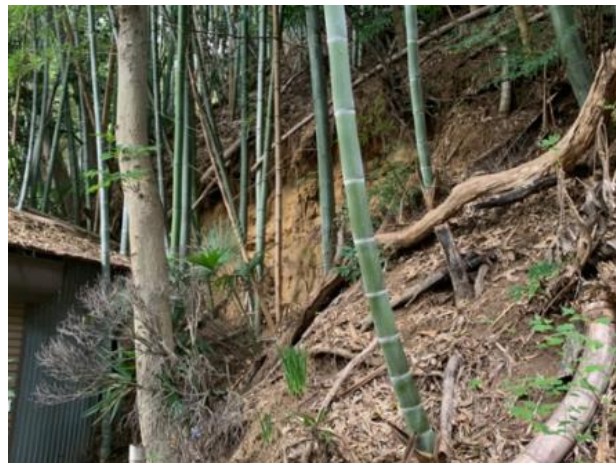
図 1.5.32 崩れかかっている急傾斜地（発表者撮影：西真鍋にて）
